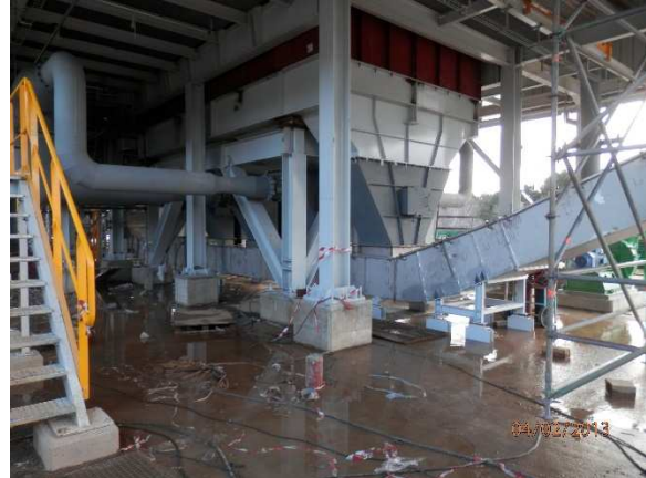
Transportador de escorias de parrilla
