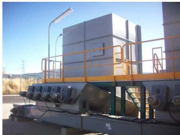
Tolvas de recepción de biomasa
