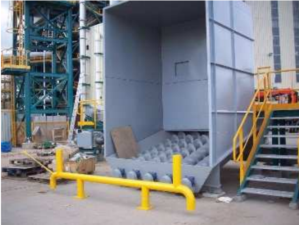
Tolvas de recepción de biomasa
