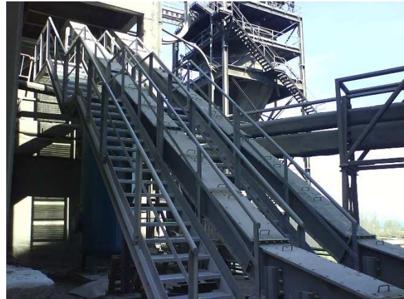
Instalación de Biomasa Planta CEMEX (Alcanar)
