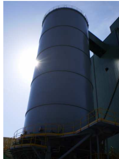
Almacenamiento de yeso de desulfuración
