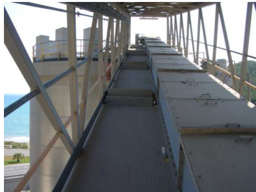
Transportador de carga silos
