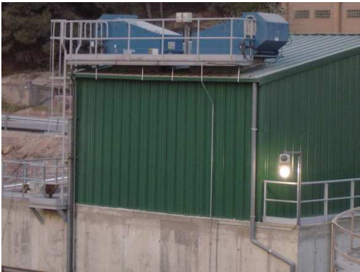
Tolva de recepción de fangos con nave y filtros de captación de polvo
