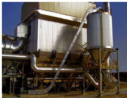
Sistema de transporte y almacenamiento de cenizas
