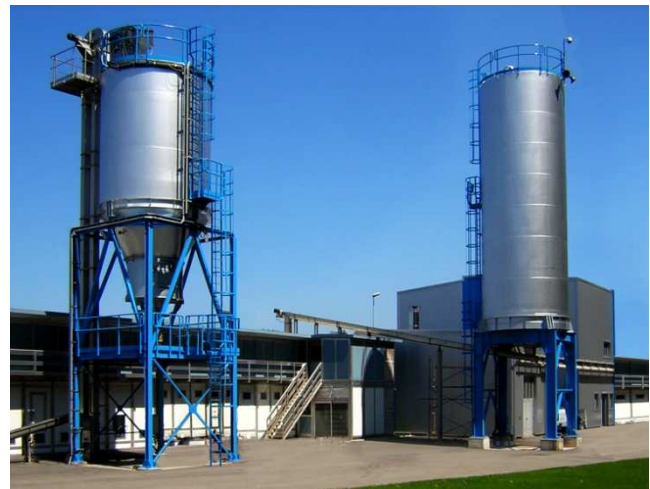
Transporte y almacenamiento de fangos de depuradora E.D.A.R. LA REGUERONA
