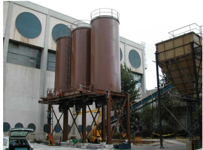
Almacenamiento de fangos deshidratados de depuradora E.D.A.R. PINEDO
