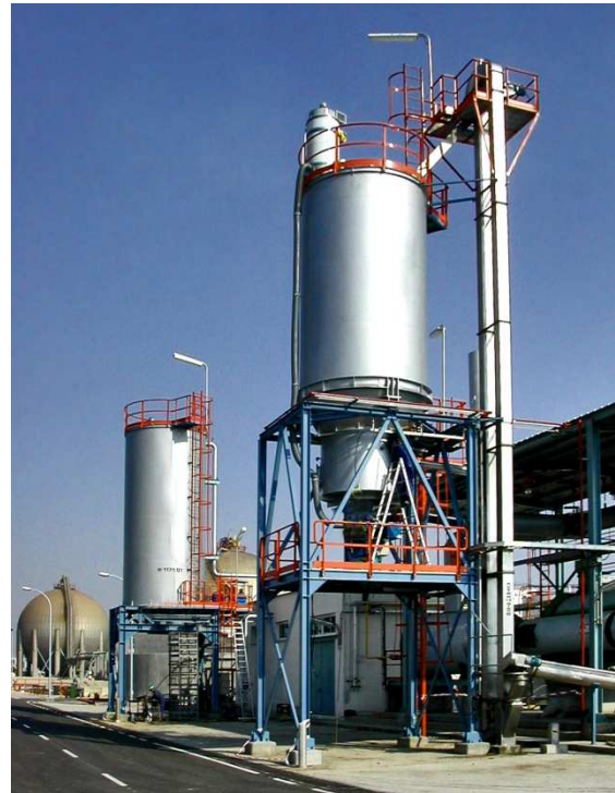
Transporte y almacenamiento de fangos de depuradora E.D.A.R. PROQUIMED
