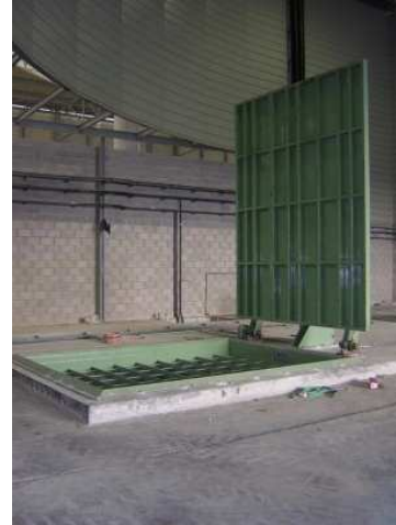
Tolvas de recepción de fango deshidratado
